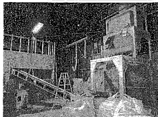
資源化プラント
